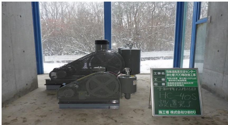
新設ばっ気ブロワ2台
