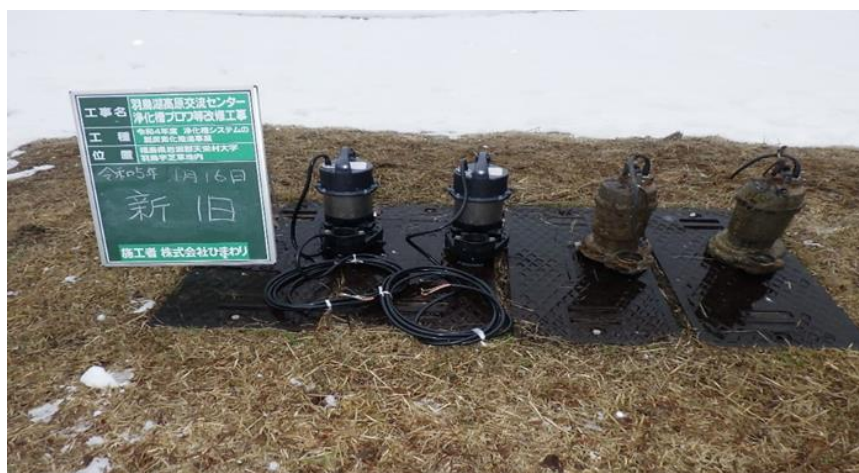
既設調整ポンプ2台およ
